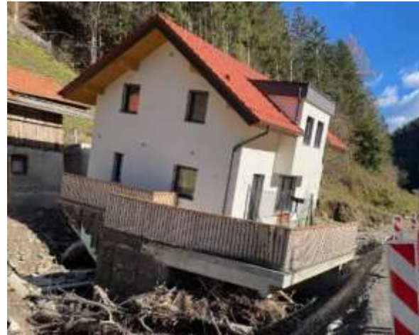
Slika 45: Uničena novogradnja v Strugah 83
