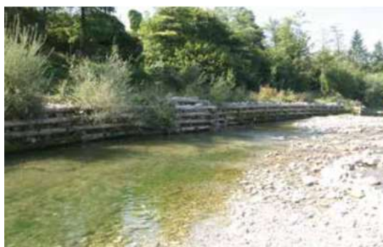
Slika 62: Zavarovanje z leseno kašto na Savinji (Foto: P. Repnik Mah, 2012) 104
