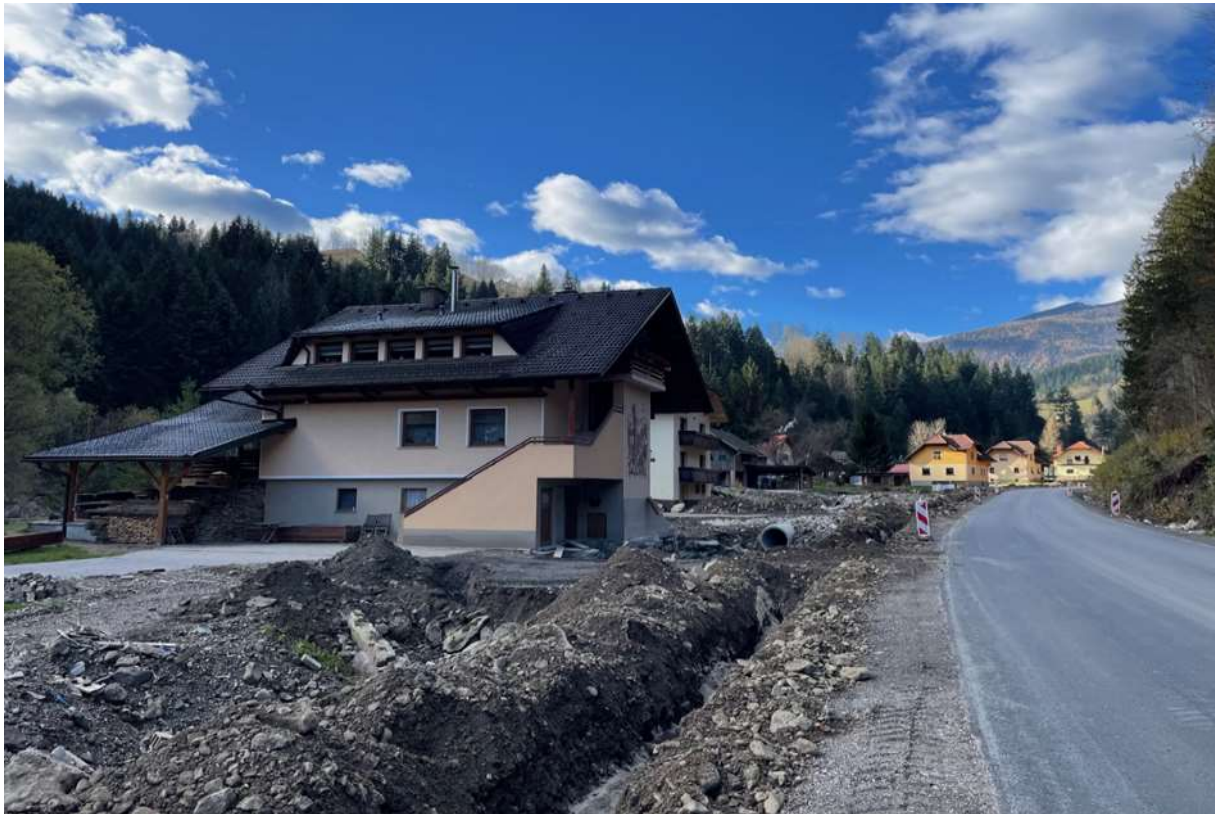
Slika 47: Odprava škode po poplavi 85
